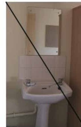
Плохо Раковина с пьедесталом. Фартук из плитки
